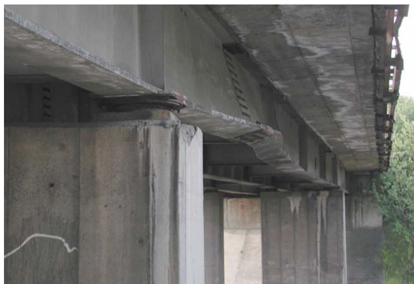
Obr. 2 Pohled na poškozený hlavní nosník mostu.
