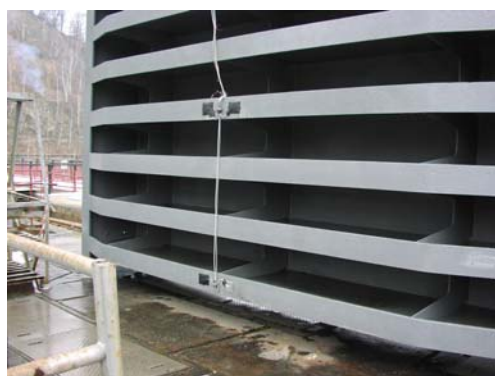
Obr.15 Zaizolované tenzometrické snímače na hradidlovej tabuli
