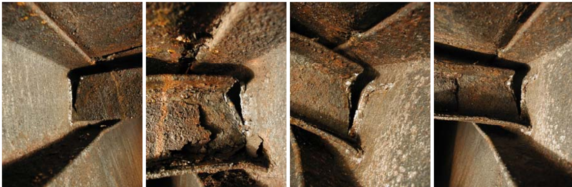
Obr.5 Porušenie spoja rebro - päťový prstenec
