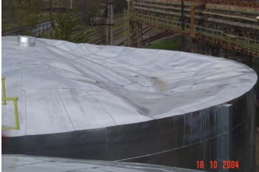
Obr.3 Strecha poškodenej akumuláčnej nádrže po havárii (zaizolovaná)
