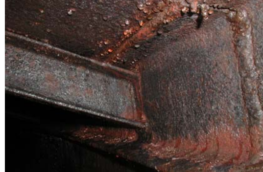
Obr.4 Porušený zvar päťového prstenca U180
