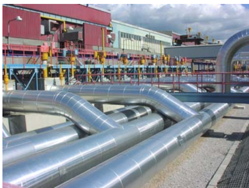
Obr.1 Potrubný dvor, potrubie sacie, potrubie medzitolaku a výtlaku
