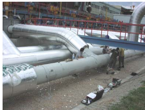
Obr.2 Naaplikované tenzometrické snímače v troch myslených rezoch potrubia výtlaku s podperou a odbočkami
