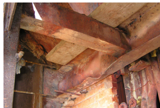
Obr.4 Plastická deformácia na spodnej pásnici rámu
