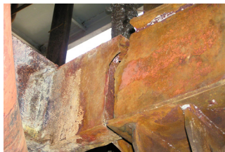
Obr.5 Porušenie nosníka rámu z druhej strany nosnej konštrukcie
